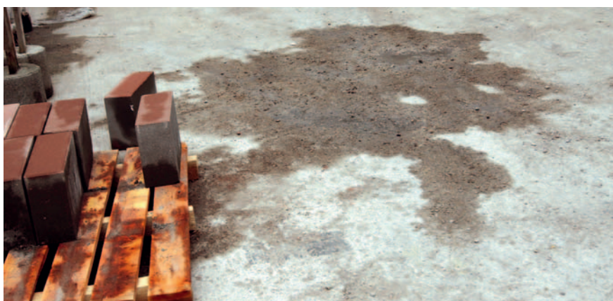
Fot. 2. Zdegradowana nawierzchnia placu manewrowego. Widoczne uszkodzenia nawierzchni betonowej, spowodowane oddziaływaniem rozsypanych resztek z uszkodzonych opakowań magazynowanej chemii budowlanej
