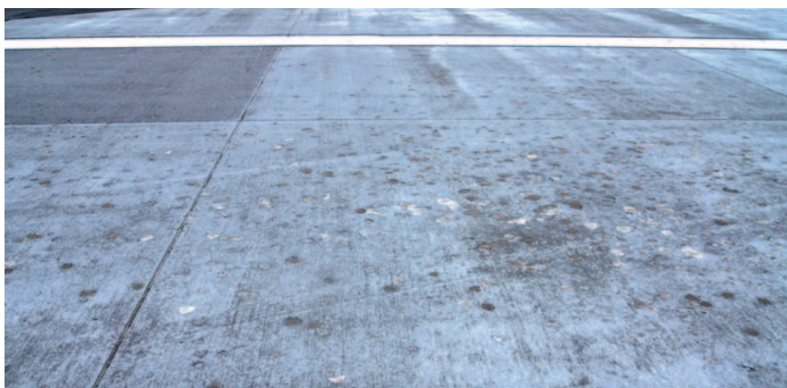
Fot. 3. Nawierzchnia betonowa zdegradowana w warunkach zimowych z powodu zastosowania kruszywa ze zbyt dużą zawartością margli
