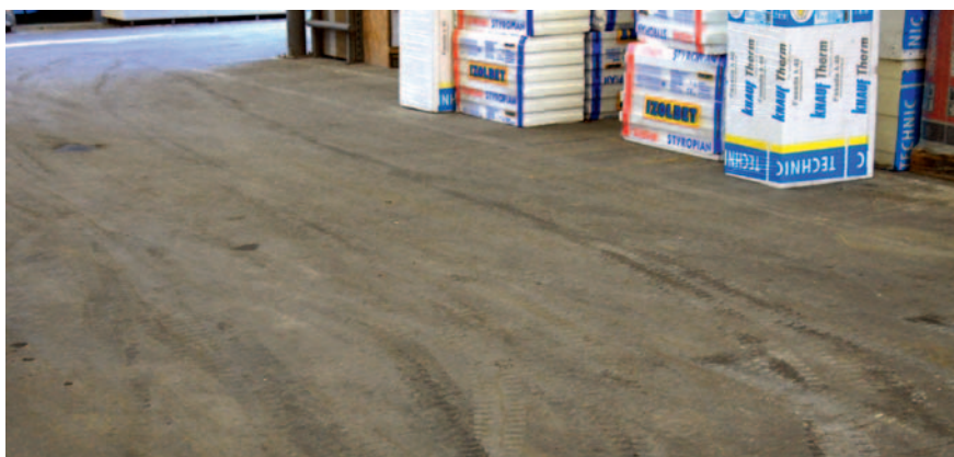
Fot. 1. Uszkodzenia powierzchniowe nawierzchni, spowodowane niedostateczną mrozoodpornością betonu. Odślonięte zbrojenie stalowe powoduje zwiększone zużycie opon samochodów dostawczych i wózków widłowych
